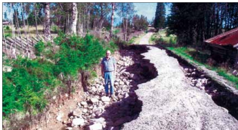
Fra skadene på Savalseterveien.
